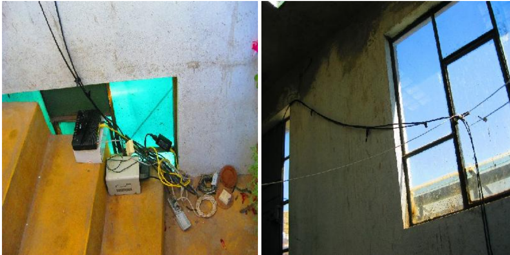
Figura 33. Ubicación temporal de router módem y bajado de cableado de la torre
