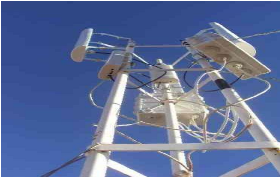
Figura 32. Torre de distribución principal (base)
