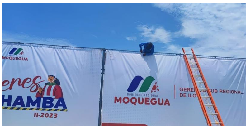
Panel metálico del gobierno regional de Moquegua
