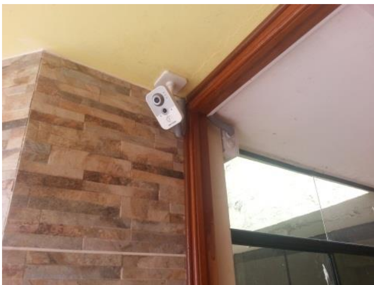
Figura 6. Cámara de seguridad ubicada en la puerta de ingreso de la empresa
