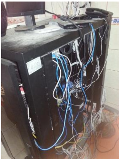
Figura 6. Cableado de red en un gabinete de la empresa
